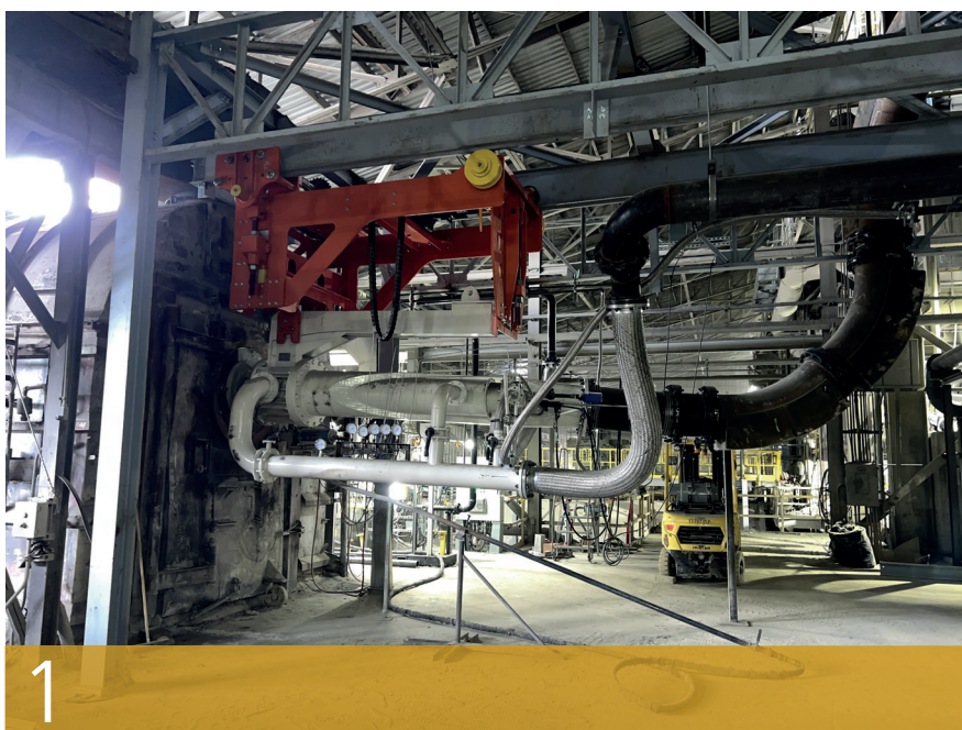
1. BRUCIATORE INSTALLATO PRESSO IL FORNO 1 DELLA CEMENTERIA DI PRYOR
